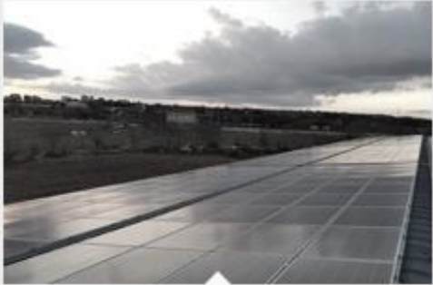
Denizli / 116 kWp ISOTRAP XL Eğimli Çatı Sistemi
