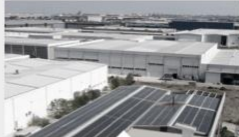
Manisa / 205 kWp ISOTRAP S Eğimli Çatı Sistemi
