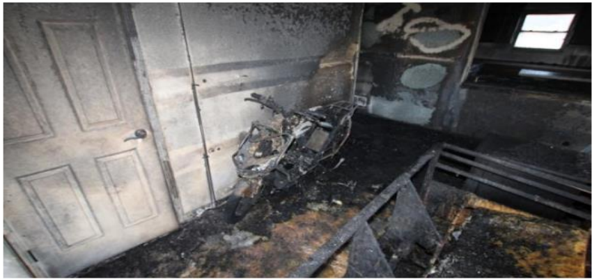
E-scooter yangını sonucu oturma odasında yangın hasarı oluştu.
